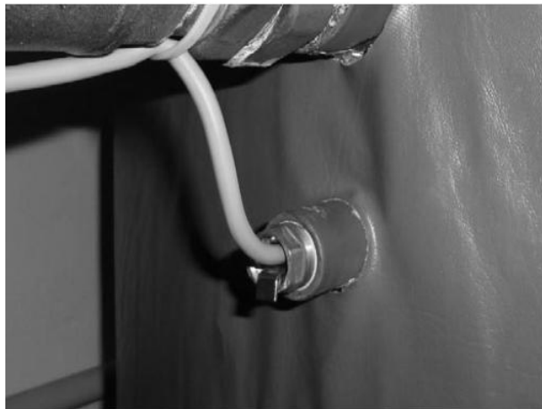
Fig. 13 – imaginea senzorului de temperatură apă în recipientul rezervorului de acumulare (TV și TS)
